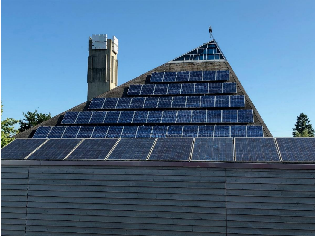
Erstes Kirchendach der Erzdiözese Freiburg mit einer Photovoltaikanlage, 1999/2000, mit dem Umweltpreis der Erzdiözese Freiburg ausgezeichnet.
