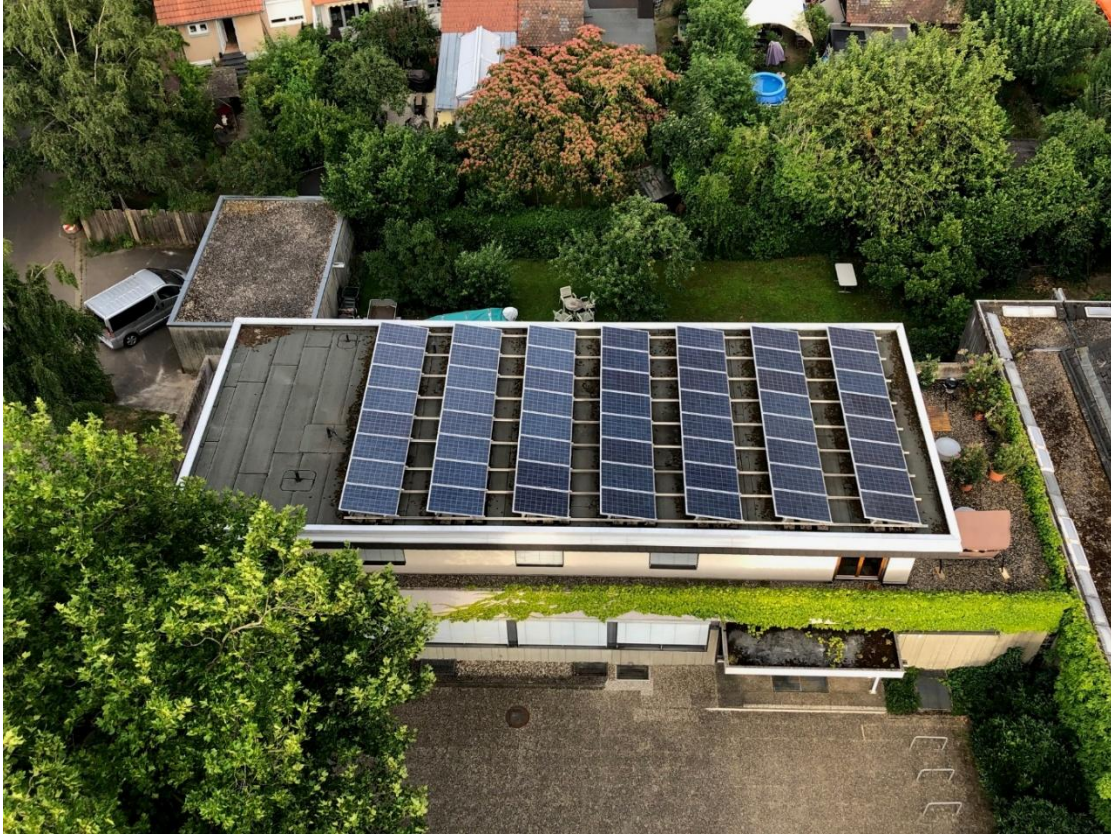
Photovoltaikanlage auf dem Pfarrhausdach St. Peter und Paul
